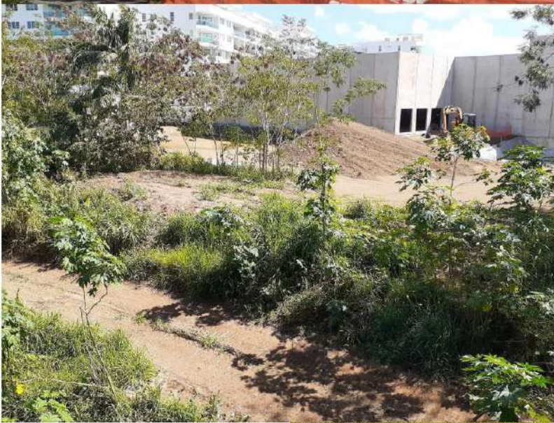
Construcción del Supermercado Pueblo. Su cercanía e impacto al Río Guaynabo. El muro de gaviones que tiene la estructura.
