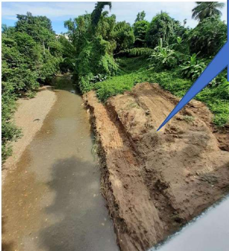
Remoción de corteza vegetal, movimiento de tierra y desestabilización de taludes en el lado Suroeste del puente que da acceso a la entrada principal de Sierra Berdecía en la Calle Alperre
