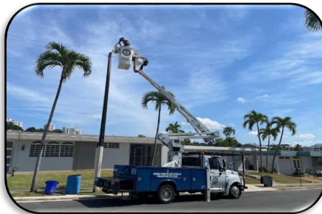
Figura 75: Arreglo de alumbrado público
