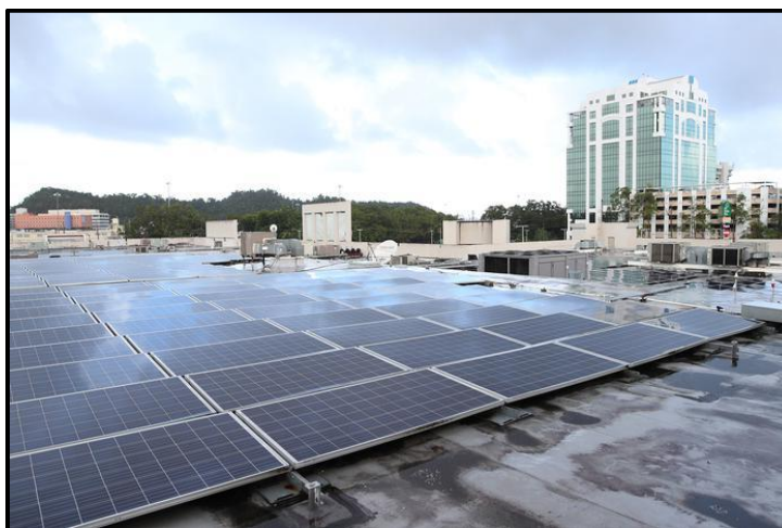
Figura 33: Paneles solares en San Patricio Plaza
