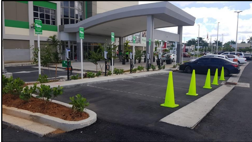
Figura 45: Estación de carga de vehículos eléctricos en San Patricio Plaza
