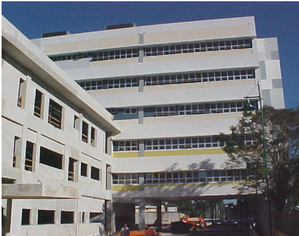
Vista de la construcción de la Escuela de Bellas Artes, la cual es uno de los proyectos más importantes realizados por el Municipio de Guaynabo.
